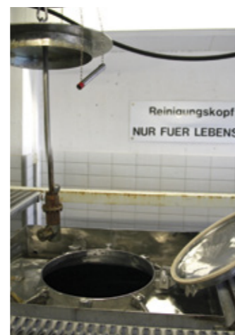
Nur für Lebensmittel: Dieser Sprühkopf in der Reinigung ist speziell gekennzeichnet.
